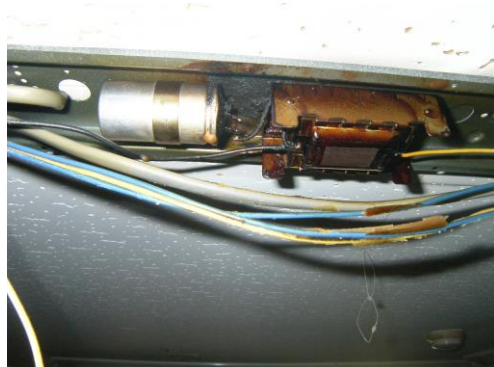
(写真1) 出火した蛍光灯の コンデンサ
